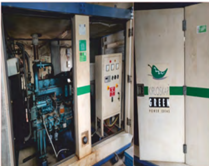
100KVA AC Generator
